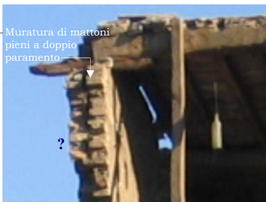
Un esempio di muratura di mattoni pieni di due teste con paramenti non ammortati
